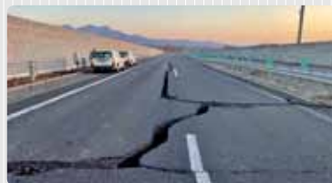
福島県沖を震源とした地震による被災直後の様子(東北道 舗装路面への縦横断クラック)
